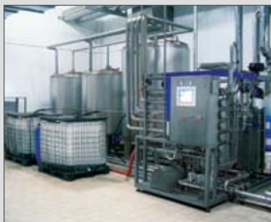
Система безразборной мойки «DONI® Pro-CIP», установленная на ОАО «Лянозовский МК»
