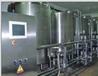
Станция CIP модульная, установленная на ЗАО «Кореновский МКК»
