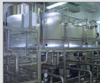
Установка CIP-модуль ЛМ 5С трехканальная, введена в эксплуатацию на ОАО «Останкинский МК»
